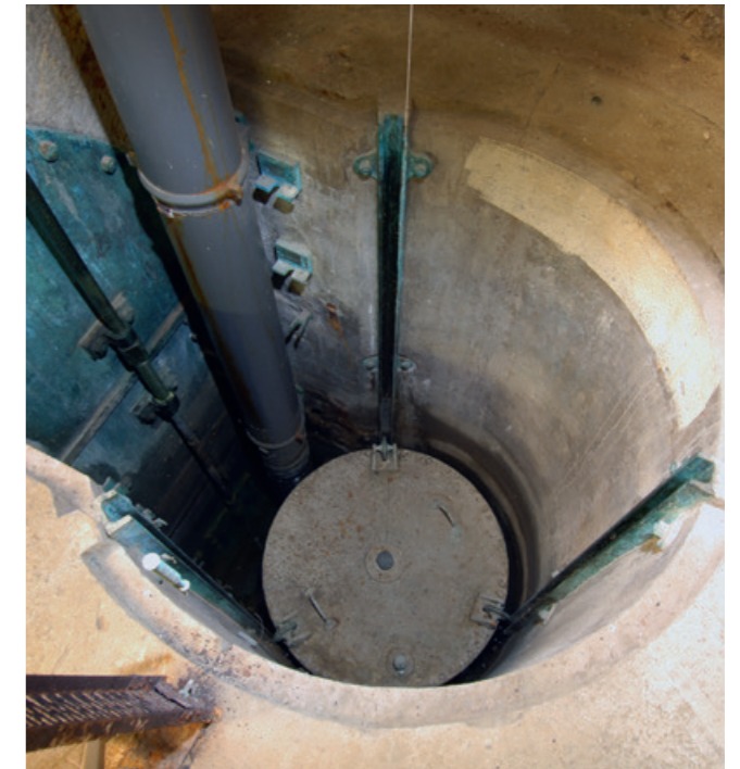
Le flotteur dans le puits du marégraphe de Marseille (Bouches-du-Rhône).
